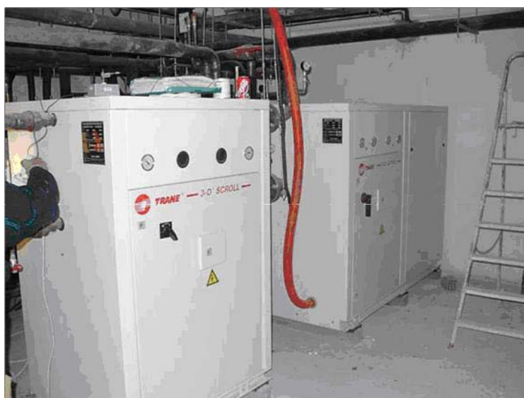
Σχήμα 2.8: Ευρωπαϊκό Κέντρο Δημοσίου Δικαίου, υδρόψυκτες αντλίες θερμότητας (Καρύτσας και Μενδρινός, 2005).
