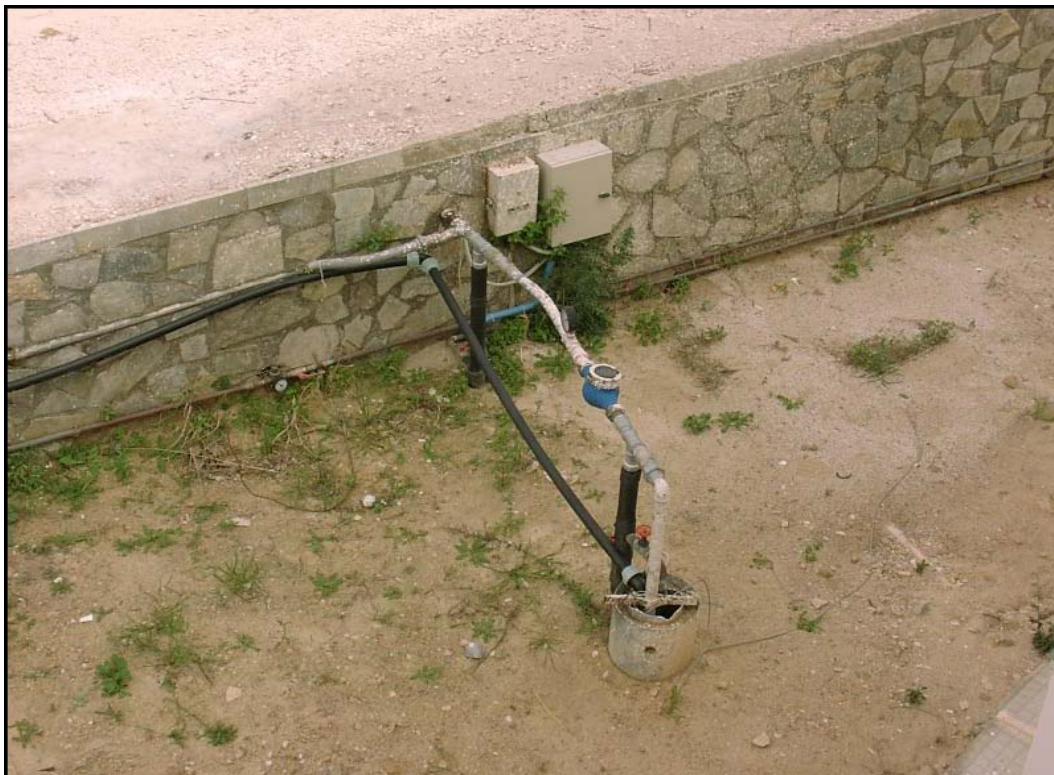
Σχήμα 2.10: Γραφεία ΚΑΠΕ, γεώτρηση που τροφοδοτεί τη γεωθερμική αντλία θερμότητας (Καρύτσας και Μενδρινός, 2005).
