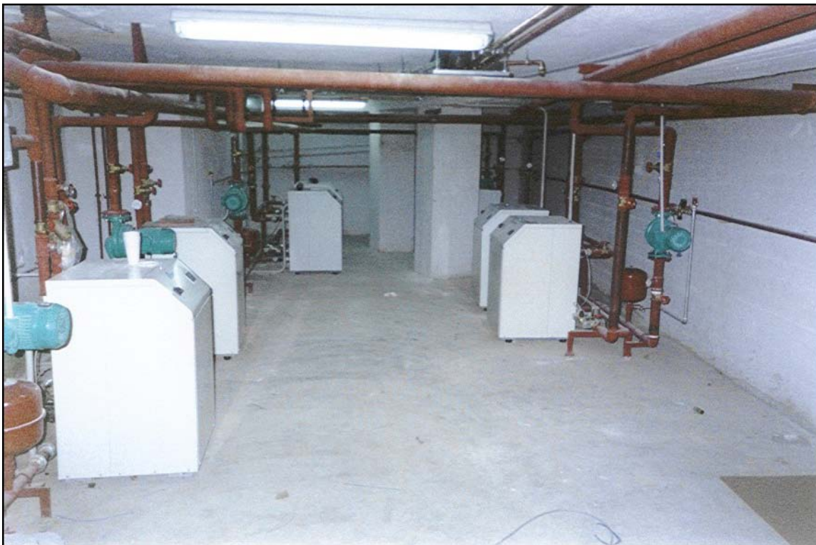
Σχήμα 2.6: Μηχανοστάσιο του Δημαρχείου Πυλαίας με γεωθερμικές αντλίες θερμότητας (Καρύτσας και Μενδρινός, 2005).
