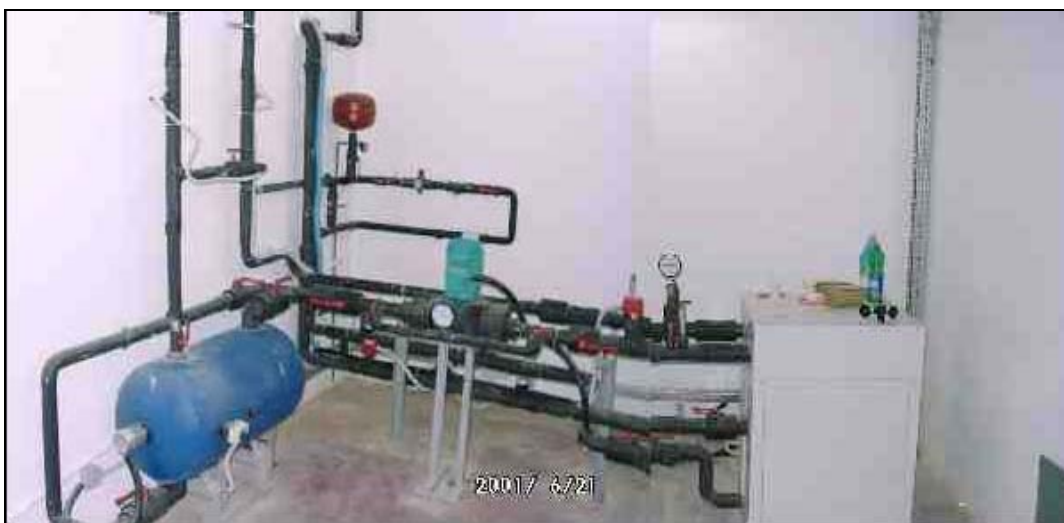
Σχήμα 2.11: Γραφεία ΚΑΠΕ, αερόθερμο δαπέδου τροφοδοτούμενο από τη γεωθερμική αντλία θερμότητας (Καρύτσας και Μενδρινός, 2005).
