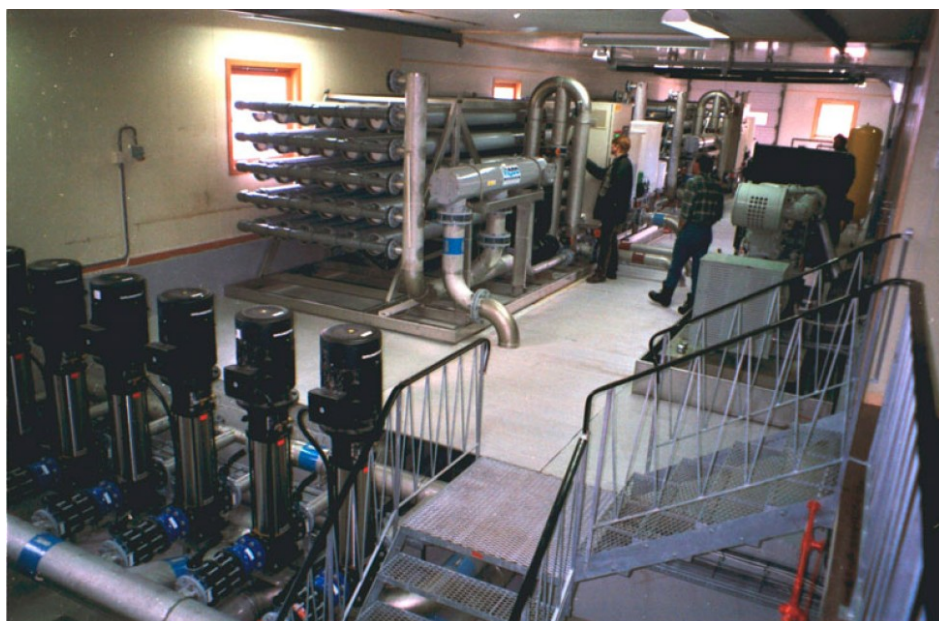
Εικόνα 3: Εγκατάσταση επεξεργασίας αστικών λυμάτων με τεχνολογία μεμβρανών- πόλη Froya, Νορβηγία
