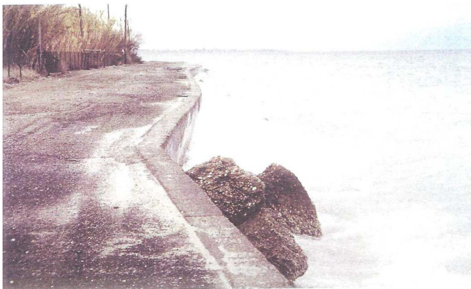
Φωτογραφία 19,20,21: Κεντρικό τμήμα της Παραλίας Διακοπτού κατάτους Φθινοπωρινούς μήνες (16.10.99), τους χειμερινούς (17.01.01) και δυτικό όριο της Παραλίας Διακοπτού, δυτικά του λιμενίσκου (Ανάκλαση των κυμάτων στο κατακόρυφο τοιχείο. 17.01.01)
