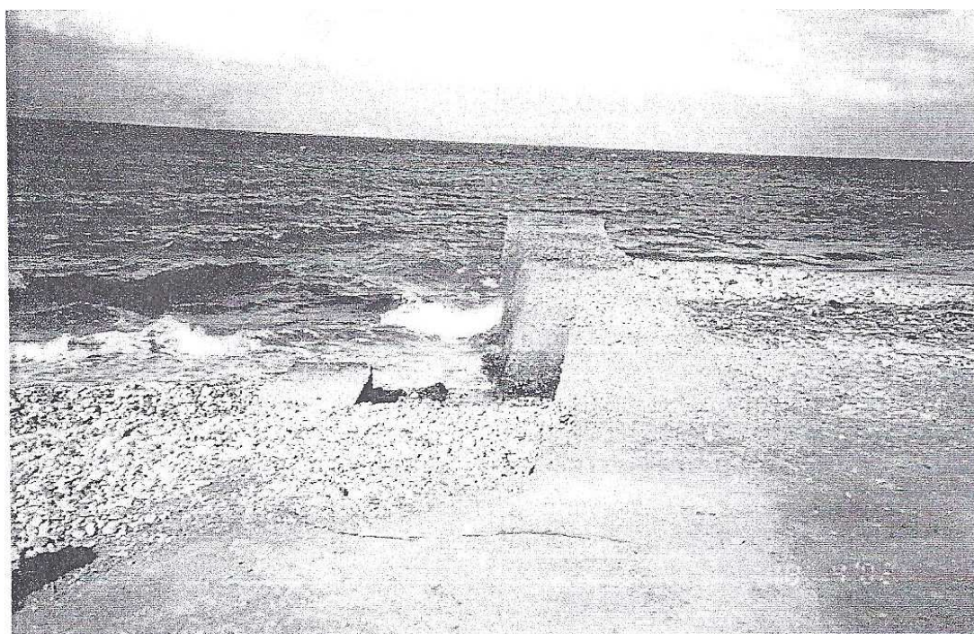
Φωτογραφία 23: Πρόβολος μήκους 25 m στο ανατολικό άκρο της παραλίας Βαλιμίτικων, διακρίνεται απόθεση υλικού στην ανατολική πλευρά του προβόλου και διάβρωση στην δυτική 18.04.2002
