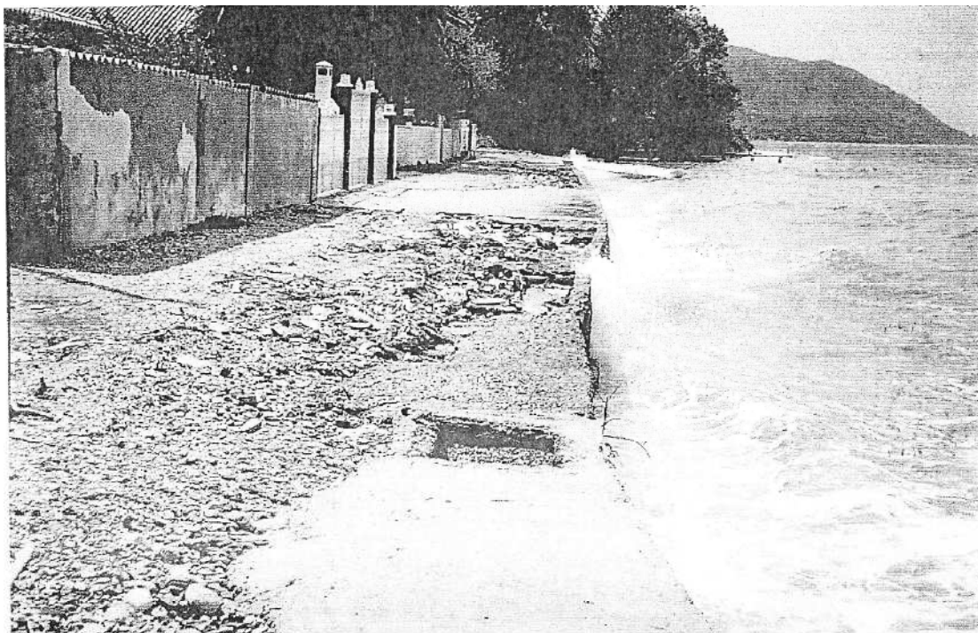
Φωτογραφία 30: Δυτικό τμήμα μελέτης παραλίας Καμαρών (Μπούκας). Διακρίνονται ζημιές στν παραλιακό δρόμο. 18.04.2002
