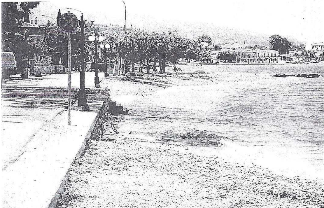
Φωτογραφία 28: Ανατολικό άκρο της παραλίας Σελιανίτικων. Το τοιχίο έχει υποσκαφτεί και παρατηρείται καθίζηση του παραλιακού δρόμου 18.04.2002
