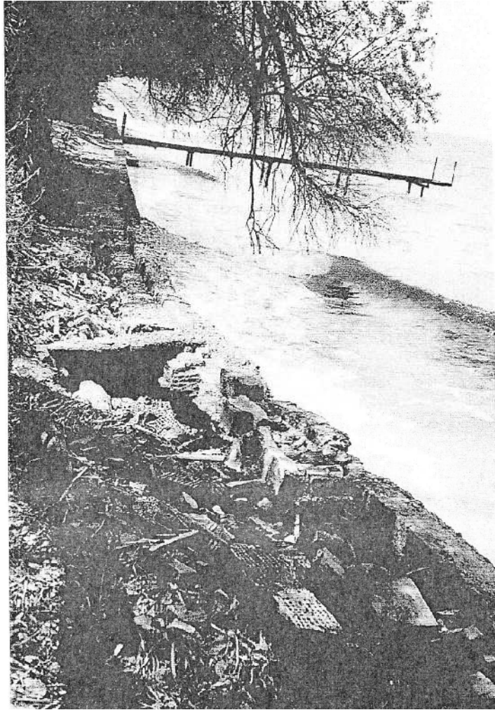
Φωτογραφία 31: Διάβρωση της ακτής και καταστροφή του τοιχίου στο δυτικό άκρο της περιοχής μελέτης 18.06.2002
