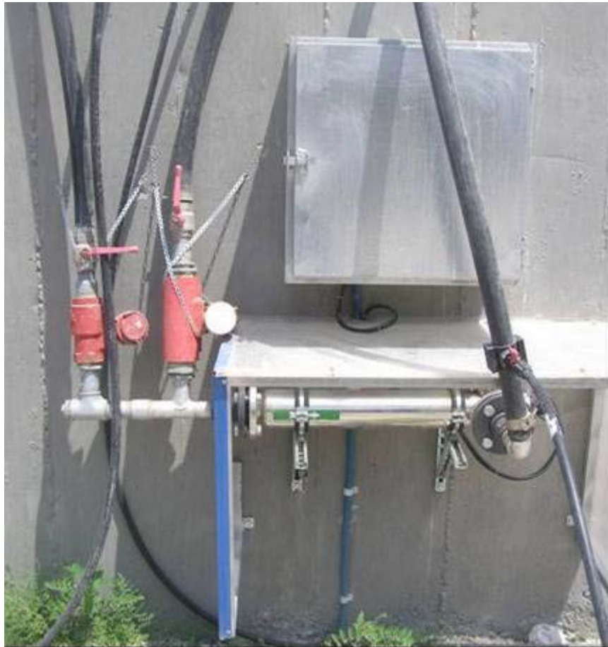
Εικόνα 7. Σύστημα απολύμανσης UV με σκέπαστρο και ροόμετρα
